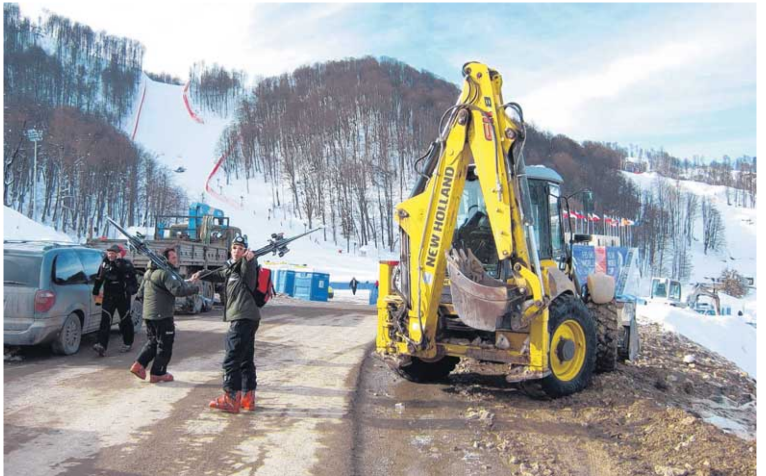
Baustelle auf dem Weg zur Skipiste: Die 22. Olympischen Winterspiele in Sotschi finden vom 7. bis zum 23. Februar 2014 in zwei Zentren – an der Schwarzmeerküste und in der Region um den rund 50 km entfernten Gebirgsort Krasnaja Poljana – statt. Fotos: dpa
