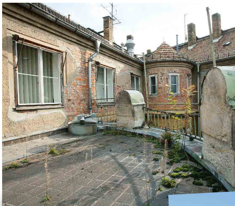
↑ Pathologie – vor der Sanierung
